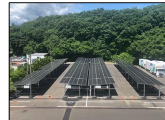
カーポート型の太陽光発電パネル
